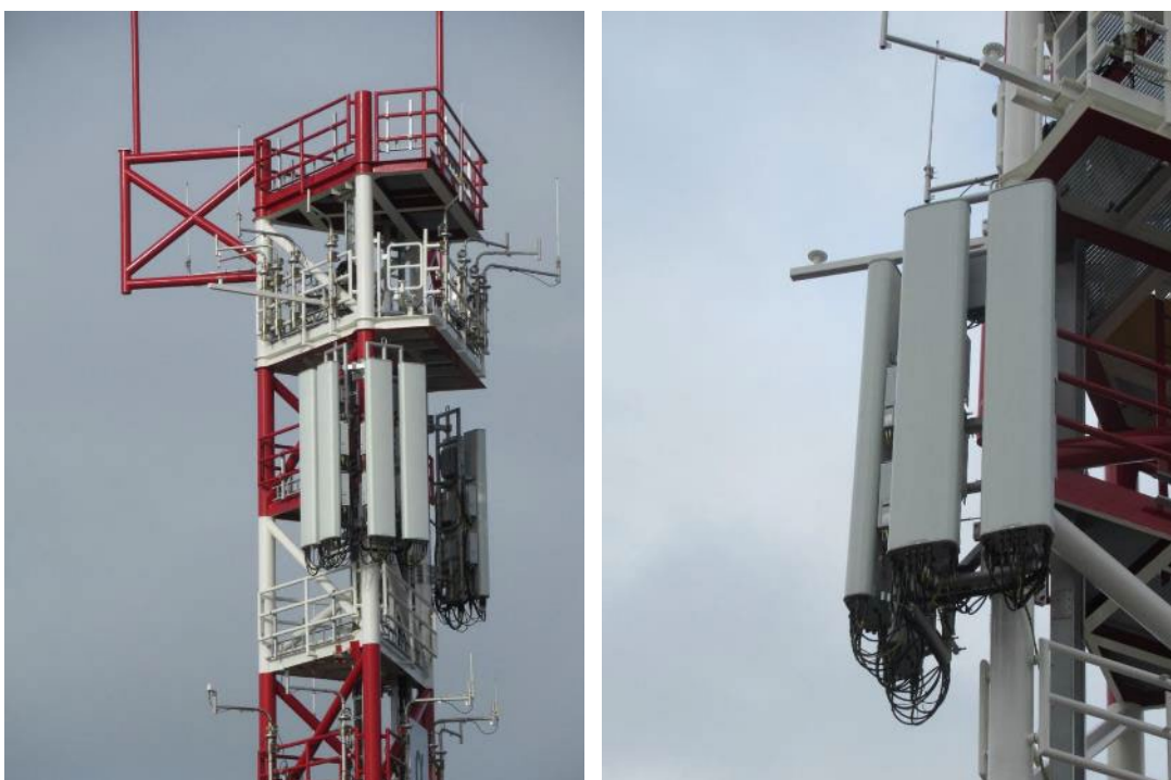
Figuur 4: T-Mobile sectorantennes op de proefopstelling voor de transformatorplatforms
